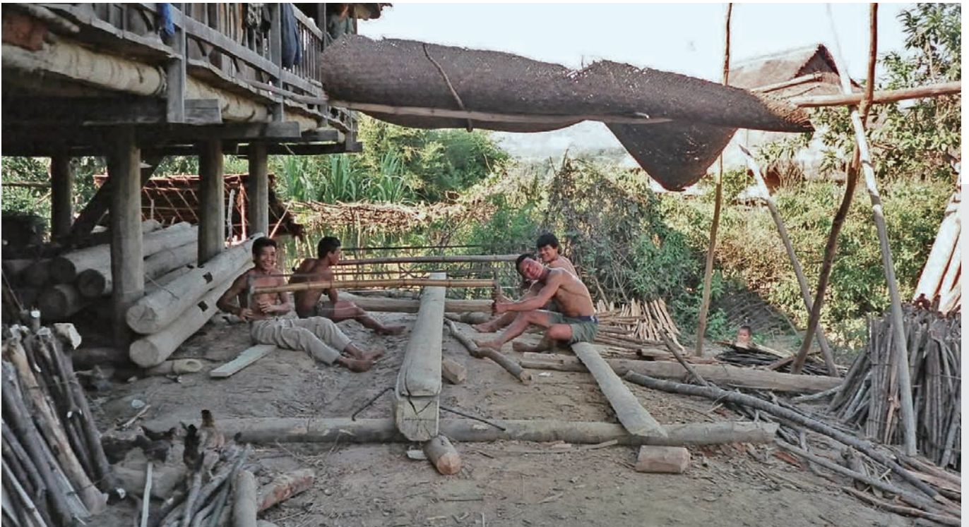
改築の数年前から、必要な柱や板を準備し、保管しておく(1997年10月、ベトナム ディエンビエン省)。
